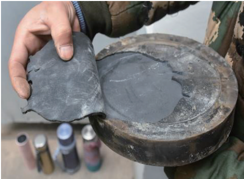
图 1 支座破损典型照片
