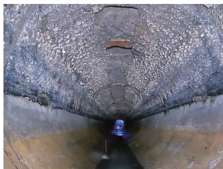
图2 管道严重腐蚀情况
