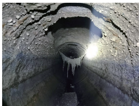
图3 管道严重腐蚀穿孔破裂
