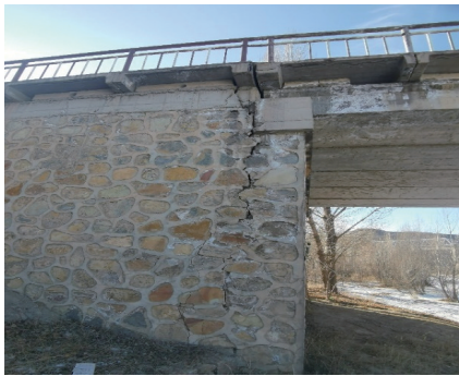
图 4 桥台竖向贯通裂缝
