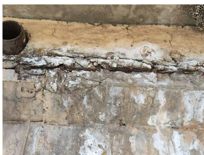
图3 空心板混凝土剥落与钢筋锈蚀
