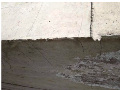
图2 空心板梁跨中L型横向结构裂缝
