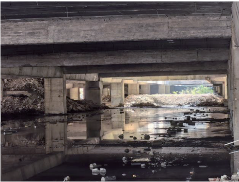
图4 商业桥地下室积水情况
