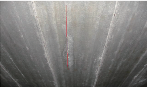
图3 桥梁结构典型病害
