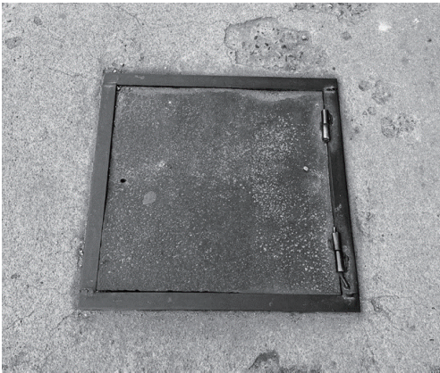
图 1 现状污水井盖
