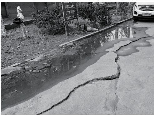
图 4 路面塌陷处积水
