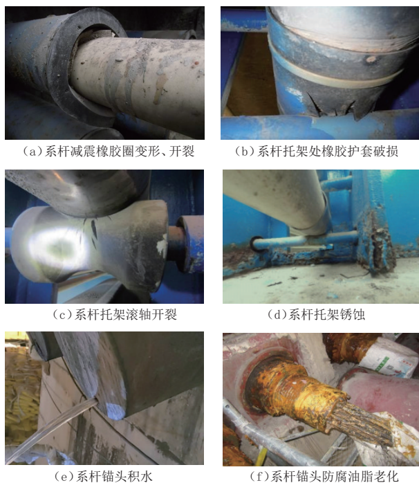
图3 系杆系统及附属构件典型病害
