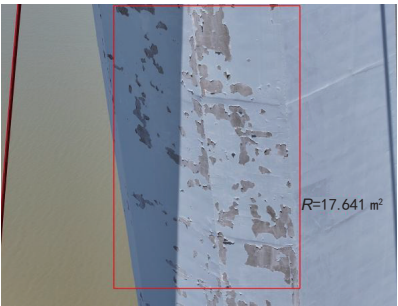
图 4 索塔涂层脱落
