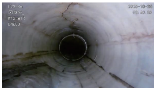
图5 管道25.7 m处缺陷
