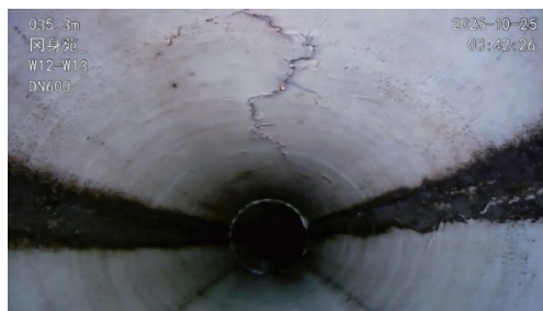
图7 管道37.3 m处缺陷
