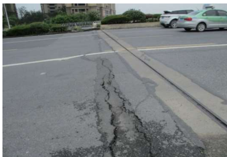
图3 桥搭板位置“桥头跳车”病害
