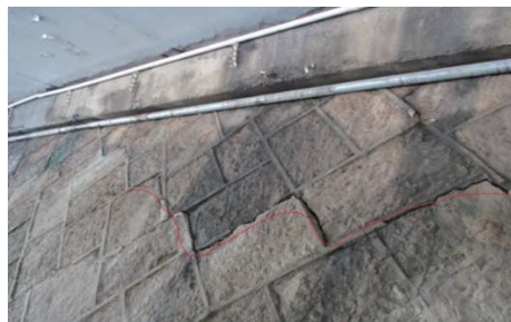
图4 2016年定检台背砌石贯穿裂缝
