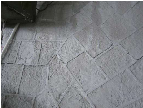
图1 2012年定检台背砌石沉降开裂
