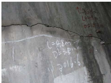
图5 2016年定检台身混凝土贯穿裂缝
