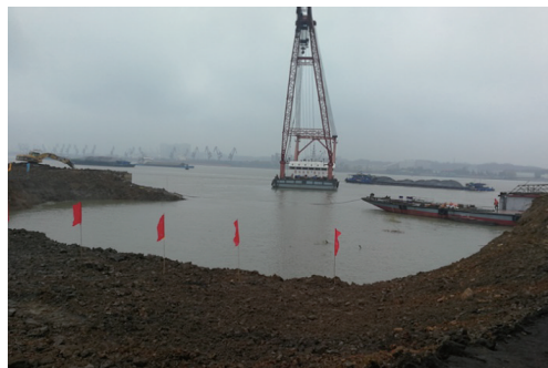
图3 坍塌区抢险处置后现场
