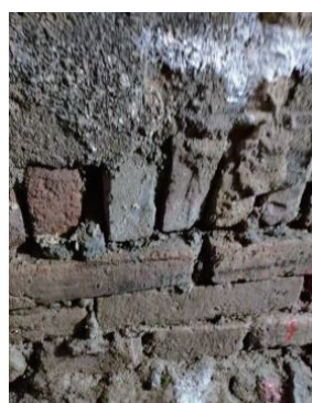
(b) 砂浆脱落
