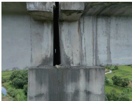
图2 墩柱大幅偏位
