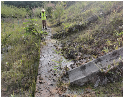
图 3 填平区对侧边坡渗水及流泥现场照片
