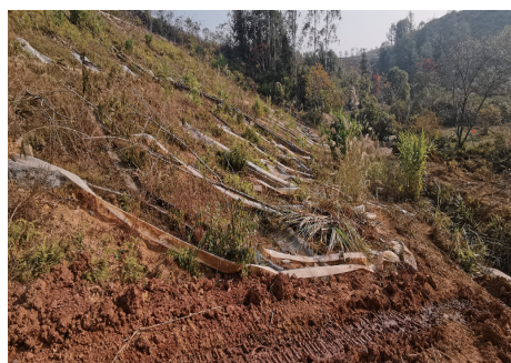
图9 边坡渗水现场照片
