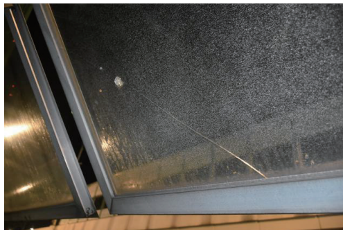
图 3 声屏障屏体开裂
