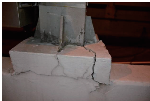
图5 龙门架底座混凝土破损
