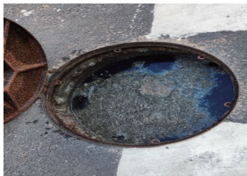
图3 片区雨污混接现场
