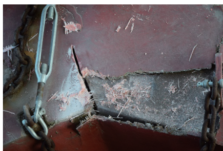
(b) 焊缝开裂,开裂长度约 750\text{ mm}
