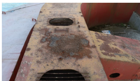
(a) 顶板锈蚀,锈蚀面积约 1\text{ m}^2
