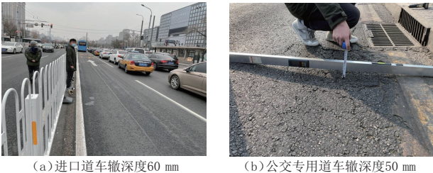
图1 2021年维修前路面车辙状况
