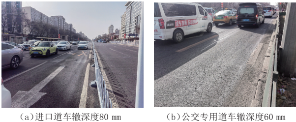
图2 2024年维修前路面车辙状况
